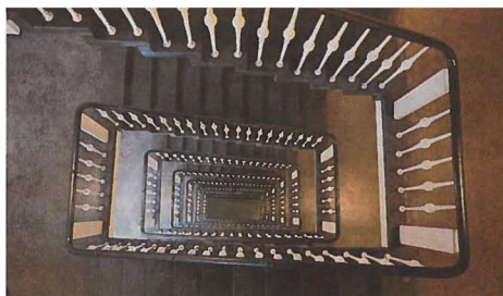
Hohes Haus: Das Geländer im Treppenhaus steht wie der gesamte Komplex aus der DDR-Zeit unter Denkmalschutz. Einen Fahrstuhl gibt es auch.
